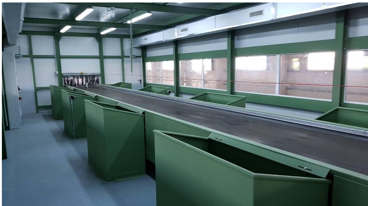
Fig. Nr. 12 - Cabina de sortare deseuri
