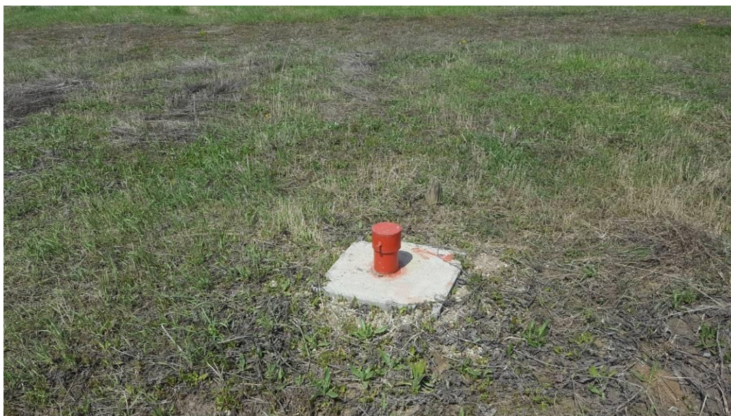
Fig. Nr. 16 - Foraj de monitorizare Nr.1 – Amonte - zona gospodarie de apa
