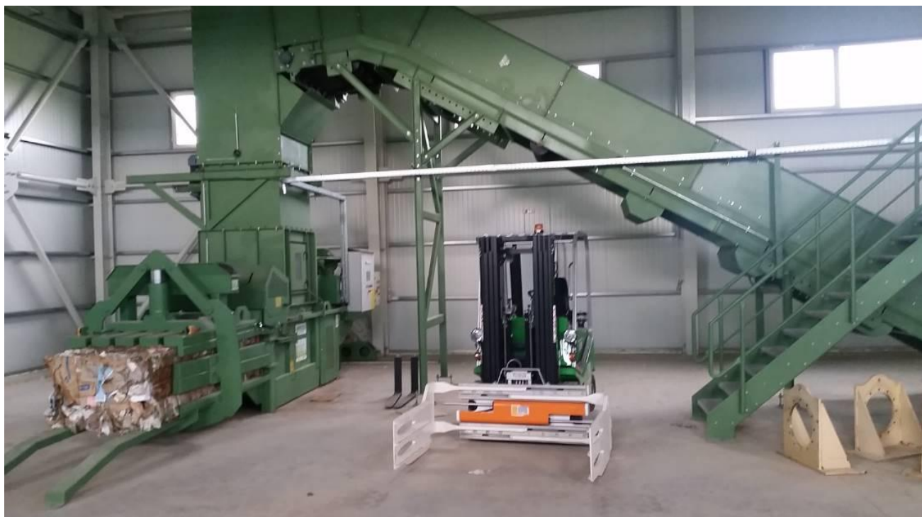
Fig. Nr. 10 - Presa de balotat deseuri
